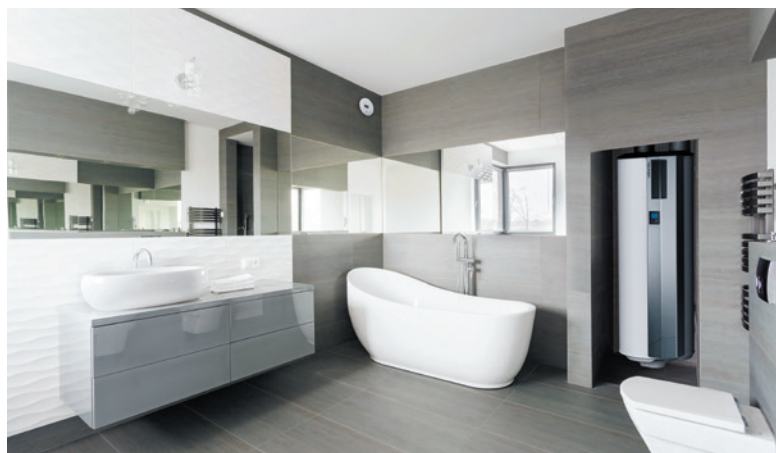
Photo 1 : Chauffe-eau thermodynamique sur air extrait. © Groupe Atlantic.
